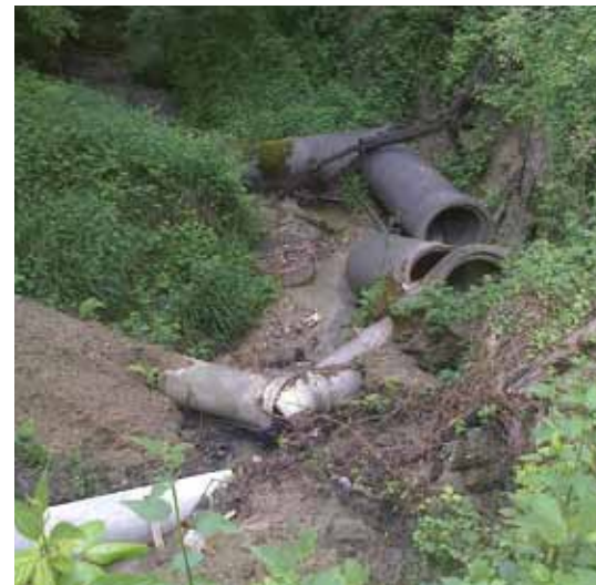
Figure 7 – Démantèlement d'un réseau pluvial par incision du lit sur un affluent de la Pichounelle
